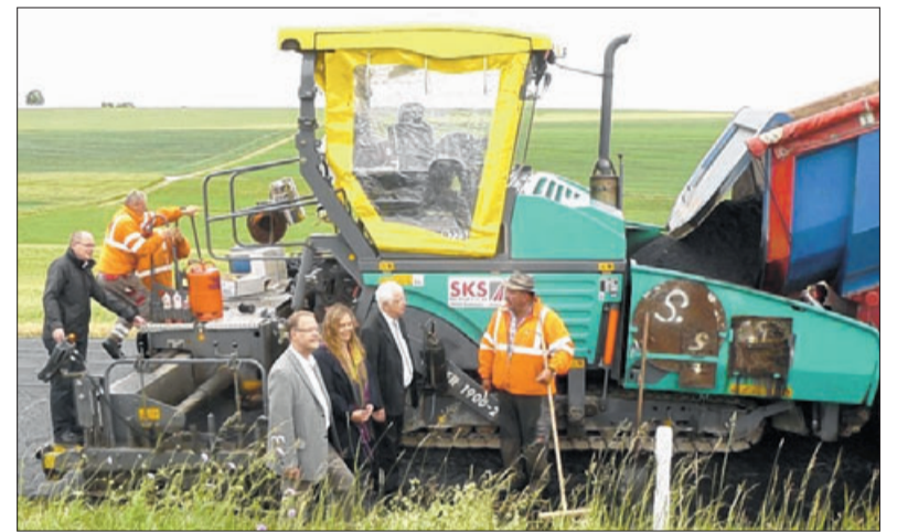
Baustellenbesuch: Bürgermeister Karl Hauler (hinter der Maschine), vorne von links die Bürgermeister Michael Lohner und Romy Wurm sowie Karl Traub im Gespräch mit Ferdinand Waldraff von der ausführenden Baufirma. Foto: Doris Moser
